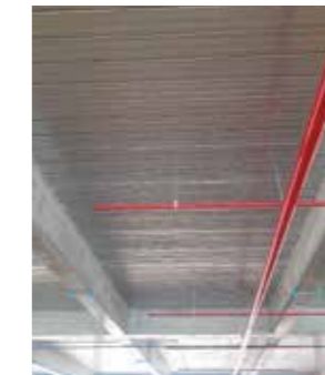
Bước 5: Lắp đặt hệ MEP hoặc hệ trần nếu có Step 5: Install MEP or ceiling system (if required)
