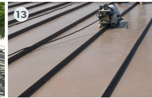
ใช้เครื่อง Seam หนีบสันลอนให้แน่น โดยเริ่มจากชายแผ่นไปจนถึงสันจั่ว Use seaming machine to seam the roof rib from eave to ridge
