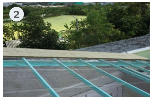
วางฉนวนร็อควูล 50 มม. Put Rockwool Insulation 50 mm.
